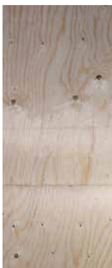
Photo 1 : face avant, non poncée, colle incolore dans le joint d'assemblage
